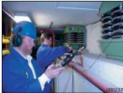
Fig. 3 Défaut d'amortissement des vibrations dans une centrale énergétique révélé par analyse FFT
